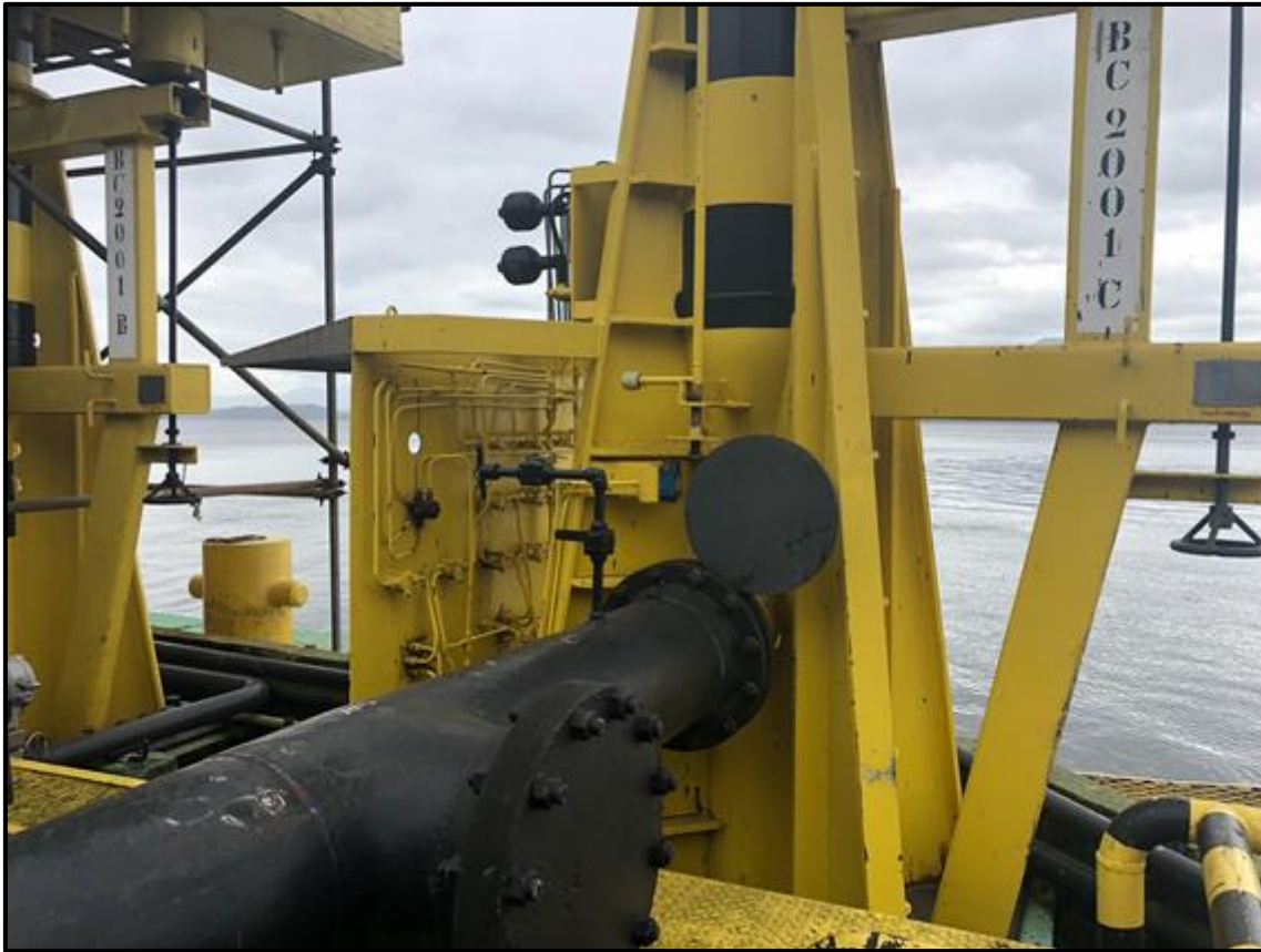
Figura 6 - Classificação Zona 1 – Conexão dos Braços de Carregamento.
